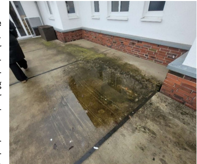
Abbildung 33: Wasseransammlung auf der Freigalerie. Quelle: GreenAdapt, 2024.
