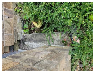
Abbildung 33: Vorsprung des Fundamentes der Kapelle. Quelle: GreenAdapt 2024
