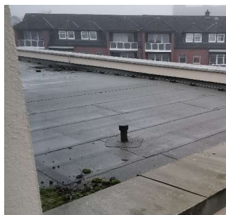
Abbildung 35: Bitumendachbahn mit Moos im Vordergrund. Quelle: GreenAdapt 2024
