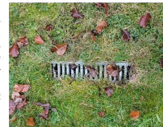
Abbildung 24: Entwässerungsrinne im Rasen. Quelle: GreenAdapt 2024
