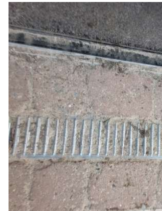
Abbildung 30: Entwässerungsrinne vor der Tür zur Terrasse. Quelle: GreenAdapt, 2024.
